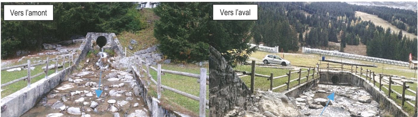
Figure 6 : Débouché du torrent des Grands Vans
